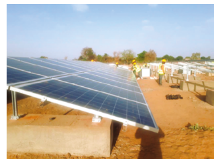
Installation de panneaux photovoltaïques dans le cadre du projet d'alimentation électrique au Burkina Faso.
