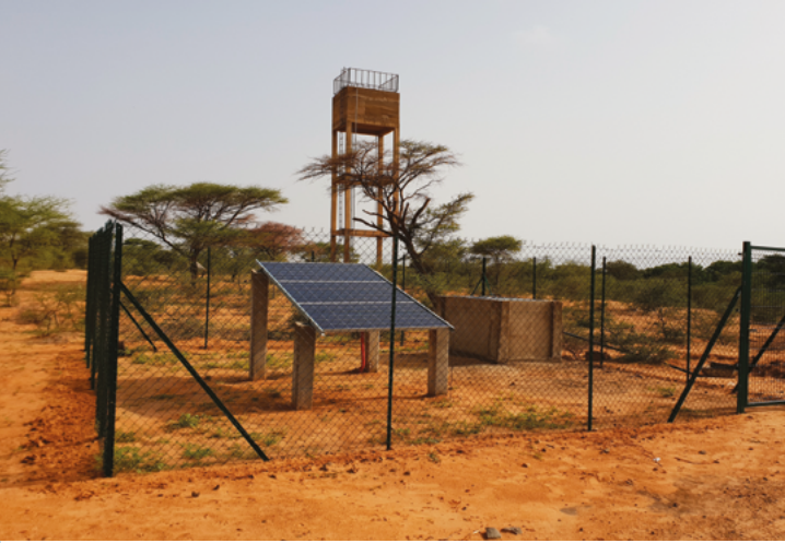
Site d'Adduction d'Eau Potable, avec pompage solaire, mis en place en Mauritanie.
